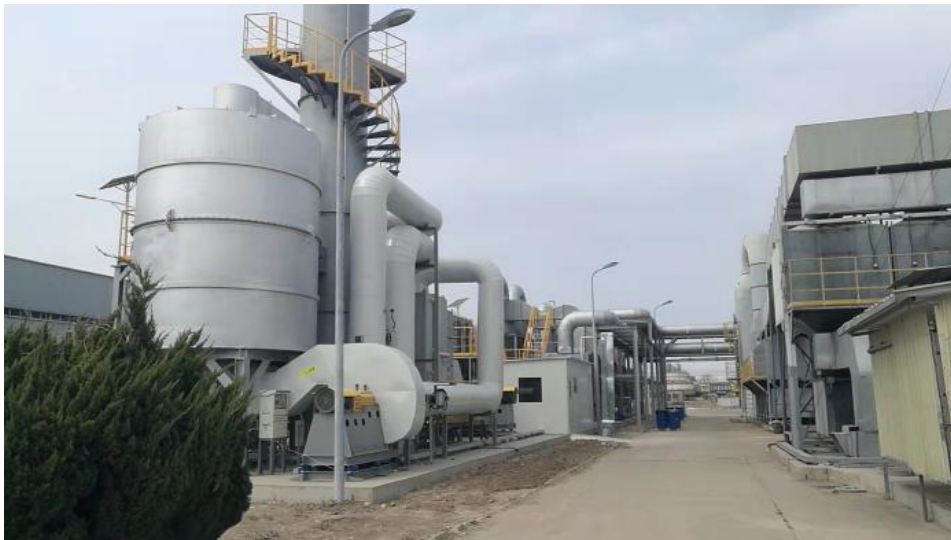
设备全貌照片
