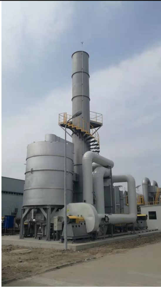
设备排气筒照片
